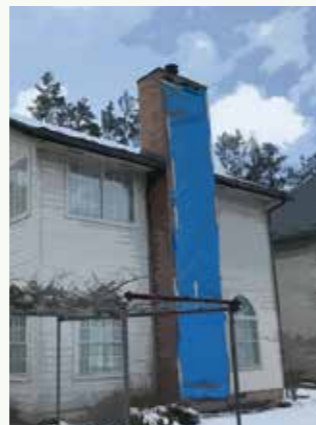
火災箇所をブルーシートで養生中
